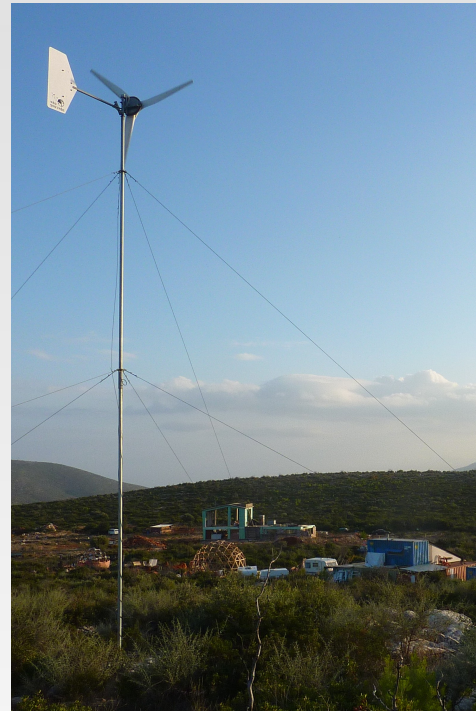
Εγκαταστάσεις συστημάτων αυτόνομης ηλεκτροδότησης με ΑΠΕ
